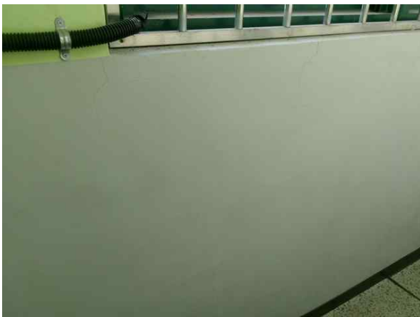
<전기실 벽체 망상균열>
