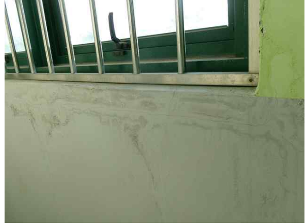
<전기실 벽체 균열>
