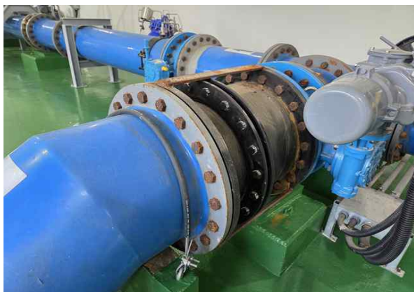
<유입밸브실 배관볼트 부식>
