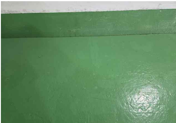
<유출밸브실 내부 바닥슬래브 균열>
