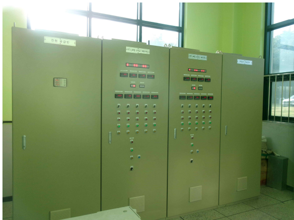
<전기실 내부 전경>
