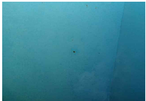
<1지 상부슬래브 백태>
