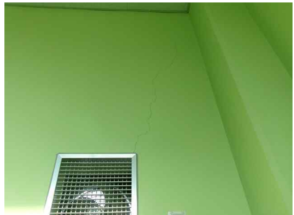
<전기실 벽체 망상균열>
