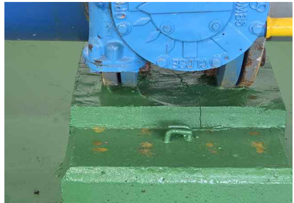
<유입밸브실 내부 설비 받침패드 균열>
