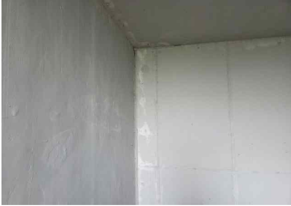
<유입밸브실 외부 벽체 균열>
