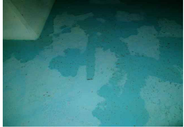
<1지 바닥슬래브 표면박리>
