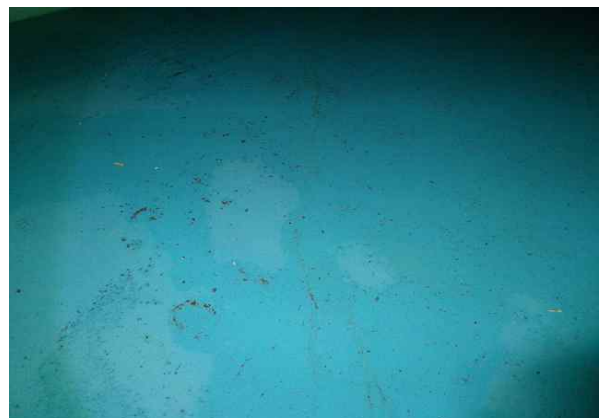
<2지 바닥슬래브 균열>
