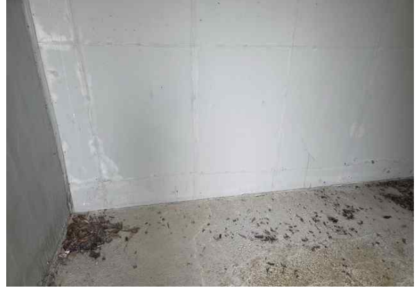
<유입밸브실 외부 벽체 균열>
