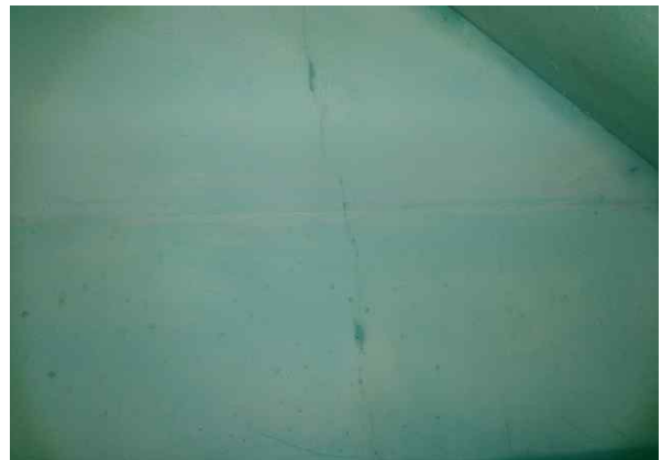
<2지 벽체 균열>
