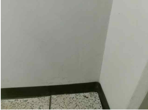
<전기실 벽체 균열>
