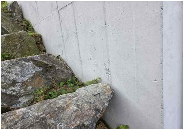
<유입밸브실 외부 벽체 파손>
