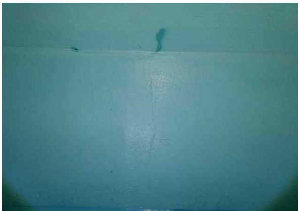
<2지 벽체 균열>
