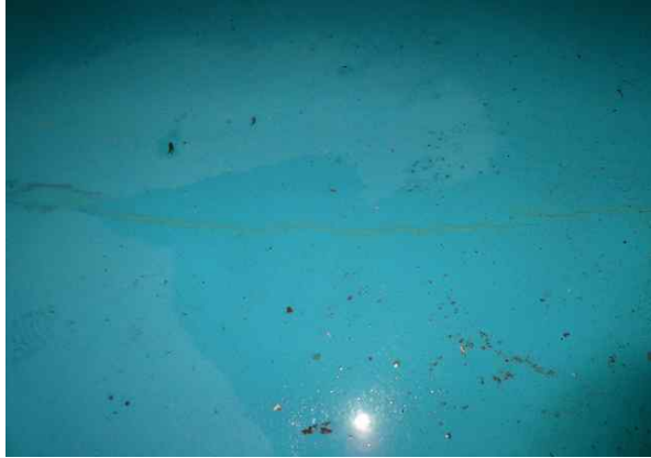
<2지 바닥슬래브 균열>
